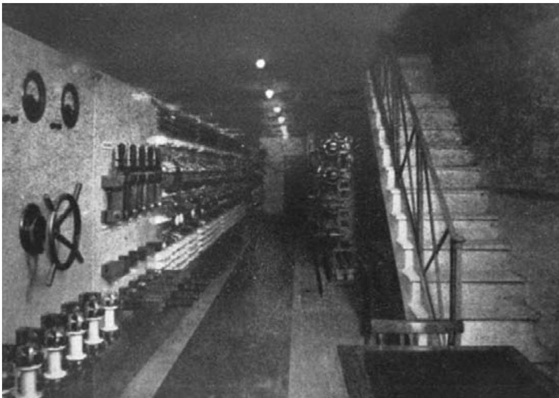
3. Il quadro di manovra, 1928 (in Ettore Salani, Illuminazione teatrale , Milano 1941).
